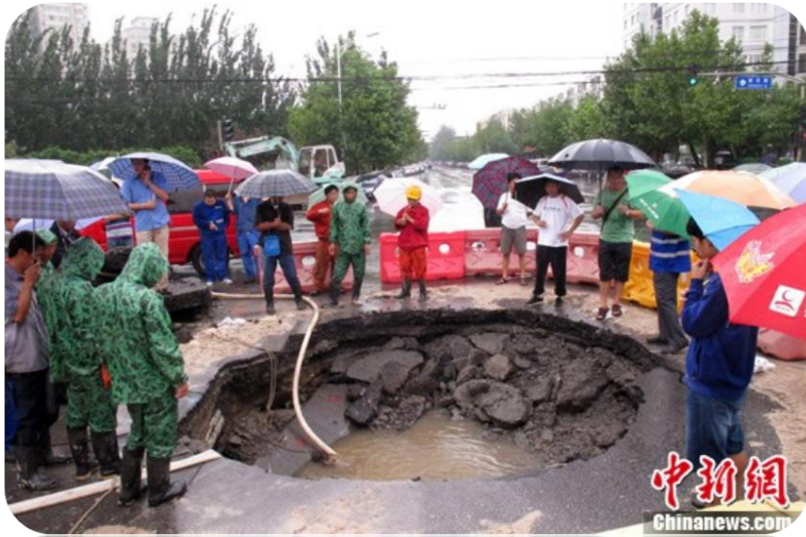
图2 “7·21”后北京市朝阳区花家地街与望花路交叉路口出现地面塌陷
